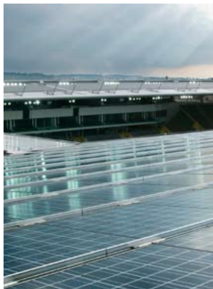
Solaranlage Stade de Suisse
