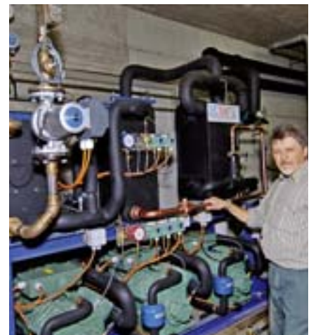
Jakob Mosimann, Besitzer des Seminarzentrums Appenberg, mit seiner neuen KWT-Wärmepumpe
